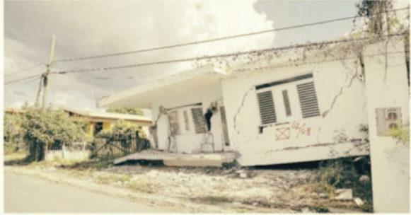
Una de las casas afectadas por los terremotos de enero del 2021 en la barriada La Esperanza, en Guayanilla. Así luce tres años después del evento sísmico.
